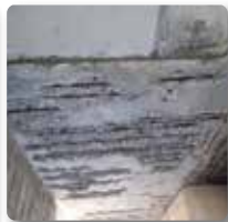
RC床版下面前面に浮き、 剥離・鉄筋露出
