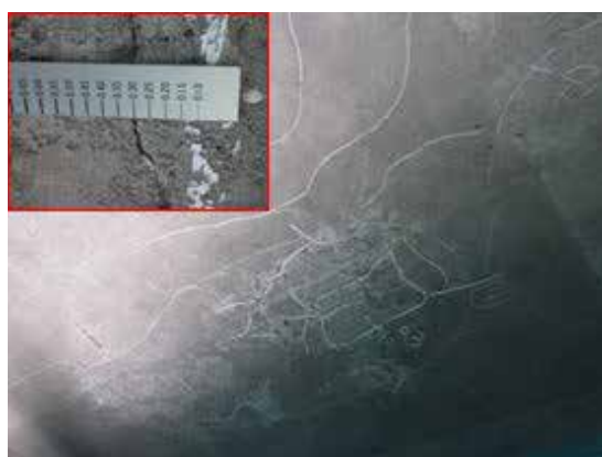
床版下面のひびわれ
