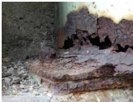
H桁橋の桁端部及び支承の腐食
