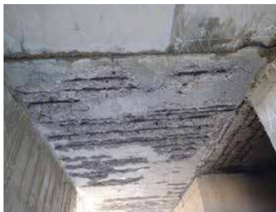
RC床版下面前面に浮き、剥離・鉄筋露出
