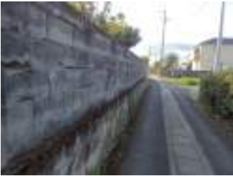
擁壁上のブロック塀
