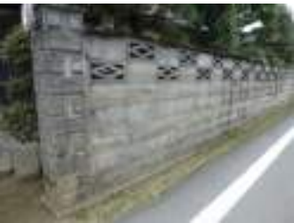
老朽化したブロック塀
