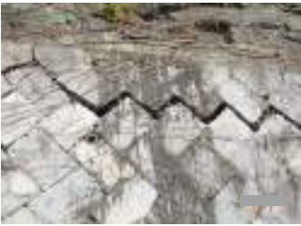
亀裂の入った擁壁・石垣
