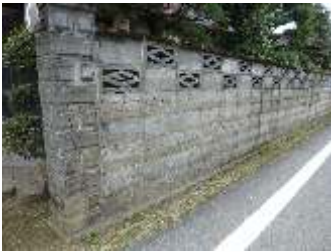
老朽化したブロック塀
