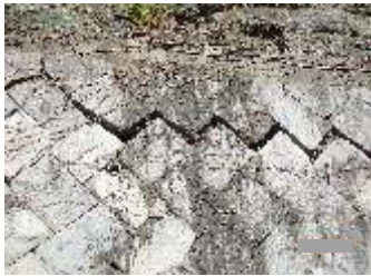
亀裂の入った擁壁・石垣
