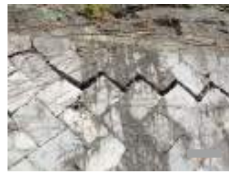
亀裂の入った擁壁・石垣
