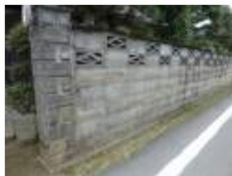
老朽化したブロック塀
