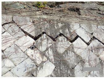
亀裂の入った擁壁・石垣
