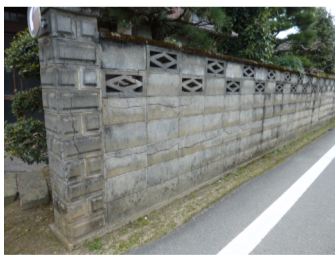
老朽化したブロック塀
