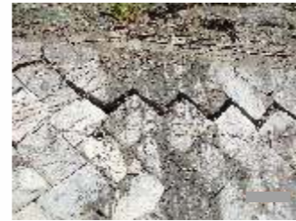
亀裂の入った擁壁・石垣
