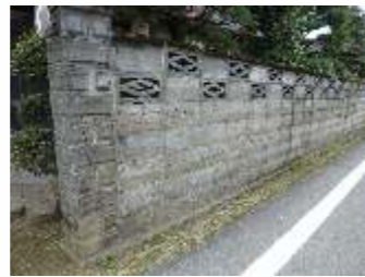
老朽化したブロック塀
