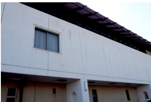
外壁・クラック錆び汁
