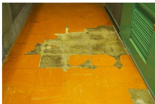
床・Pタイル破損
