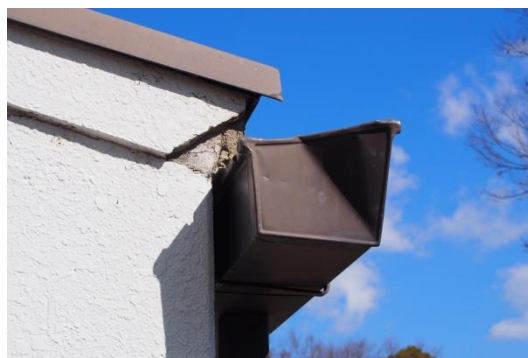
屋根・軒樋損傷
