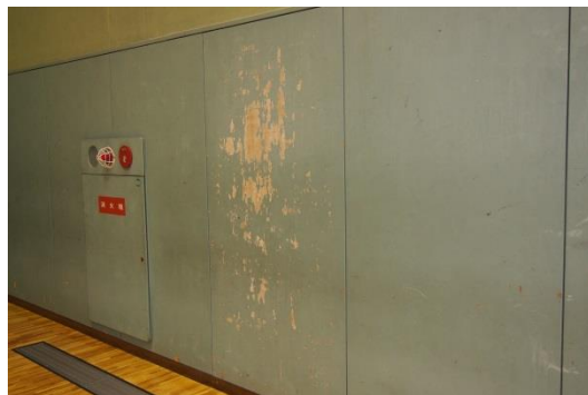
内壁・塗装剥がれ
