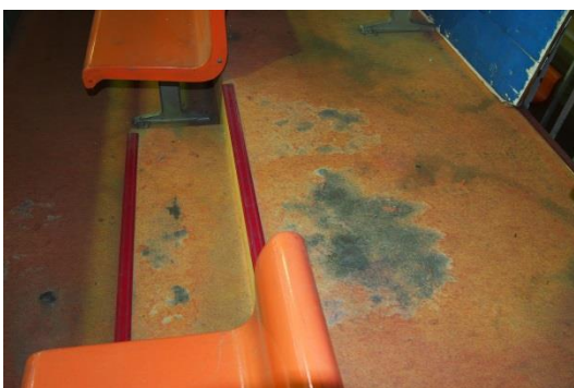
床・カーペット剥がれ
