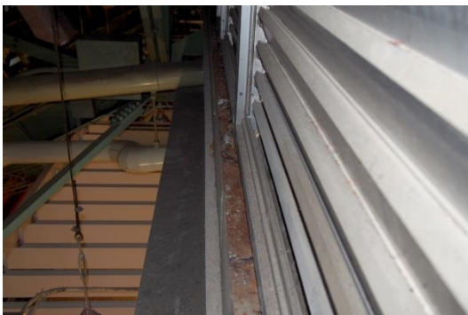
窓・雨返し内樋の腐食劣化
