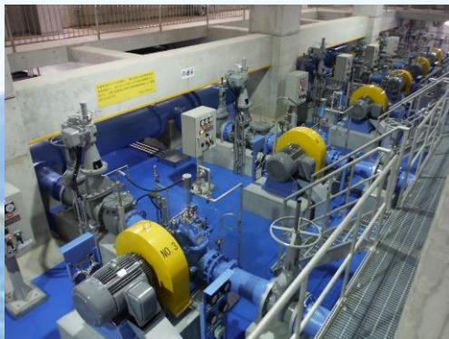
共通系送水ポンプ
