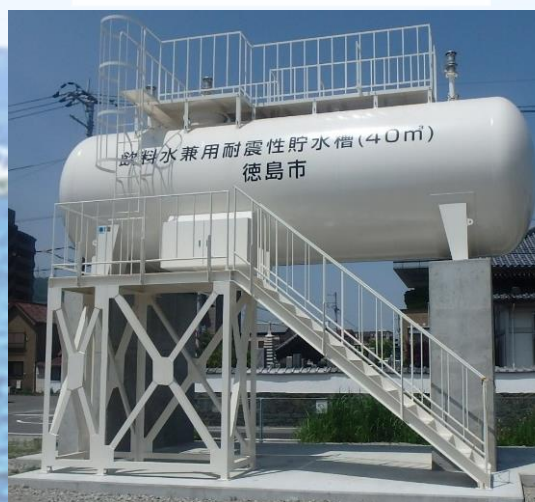
中前川耐震性貯水槽(40m 3 )
