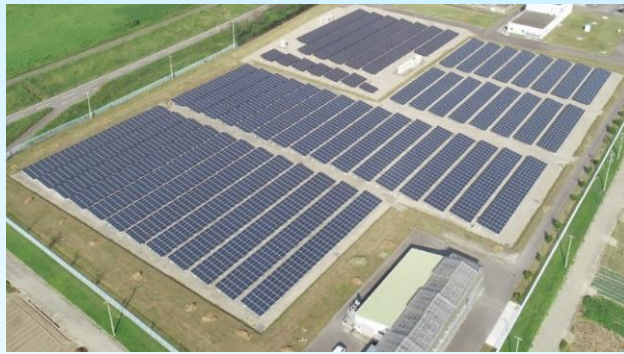
大規模太陽光発電設備(1.5MW) 自家用太陽光発電(500kW)
